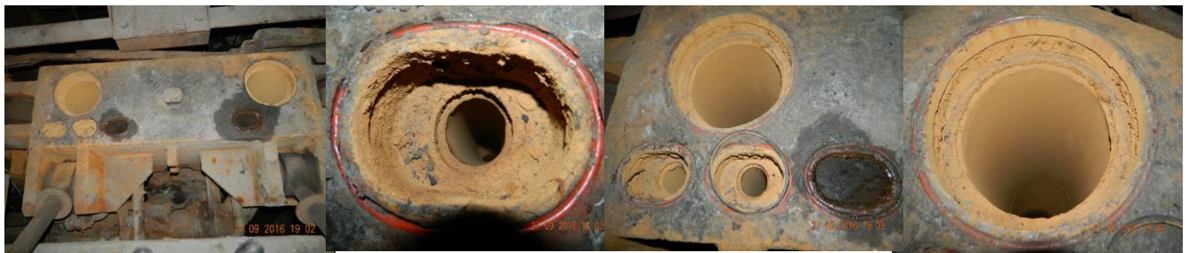
Рисунок 4 – Зношена канавка під ущільнення
