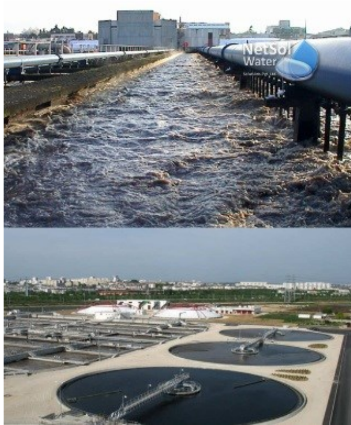
Рисунок 2.1 – Аеротенк + відстійник на станції аерації
