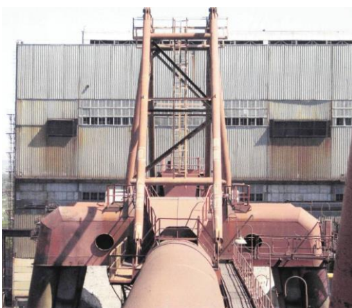
Фото 2. Частина загального вигляду крана-перевантажувача вантажопідйомністю 32 т, виготовленого в 1975 р.
