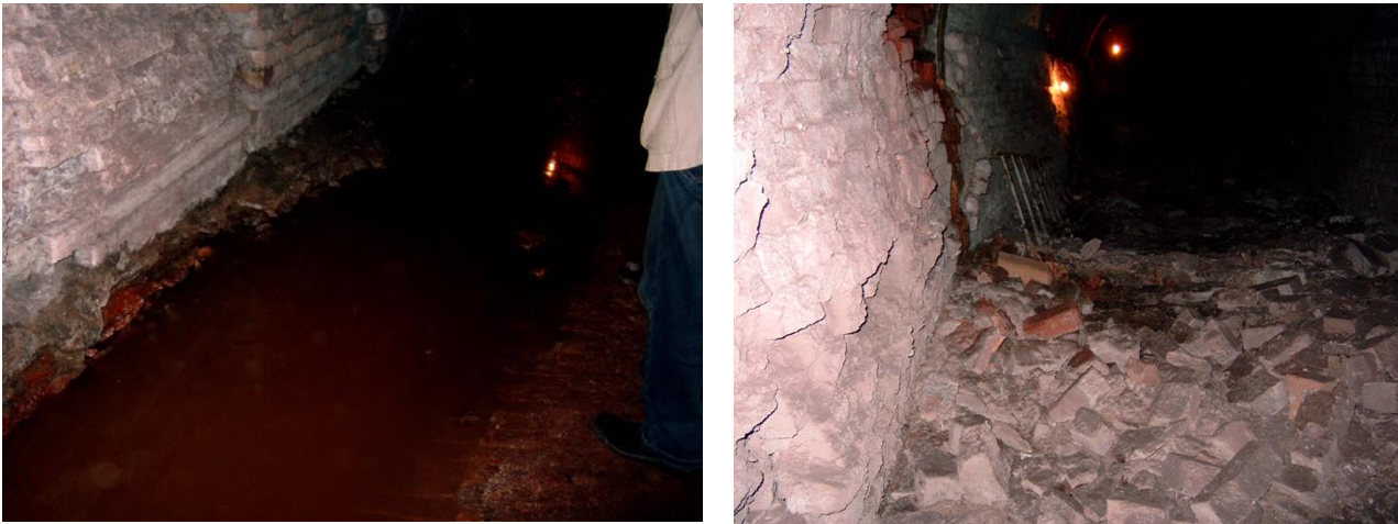
Рисунок 1 Стан виходу до димаря блоку повітрянагрівачів в період капітального ремонту
